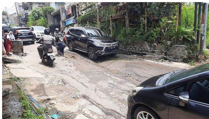
Gambar 2. Kondisi Jalan di Sersan Bajuri
