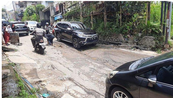
Gambar 2. Kondisi Jalan di Sersan Bajuri
